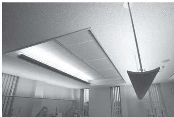
天井の間接照明と空調の吹出口
